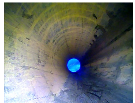
配管内部映像
