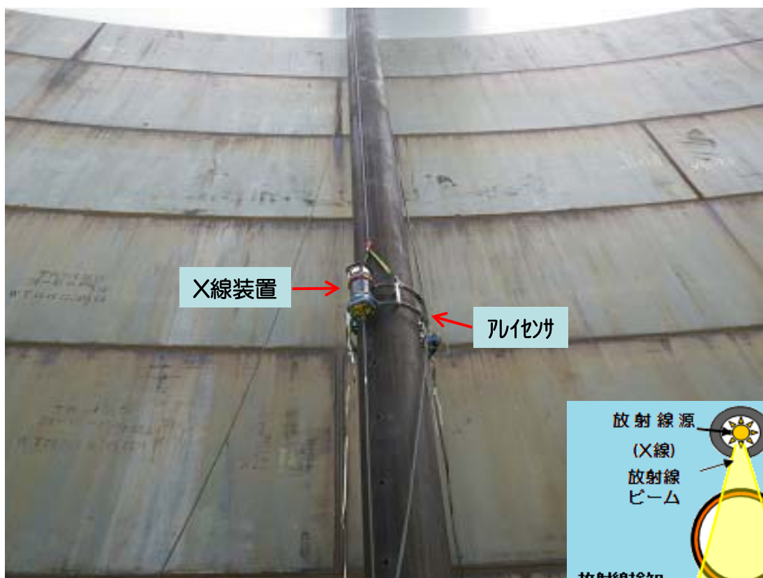
ゲージポールの腐食検査状況
