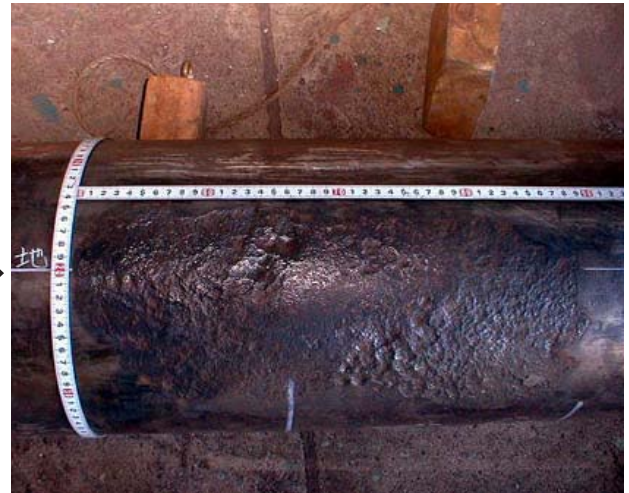
配管腐食部(撤去清掃後)
